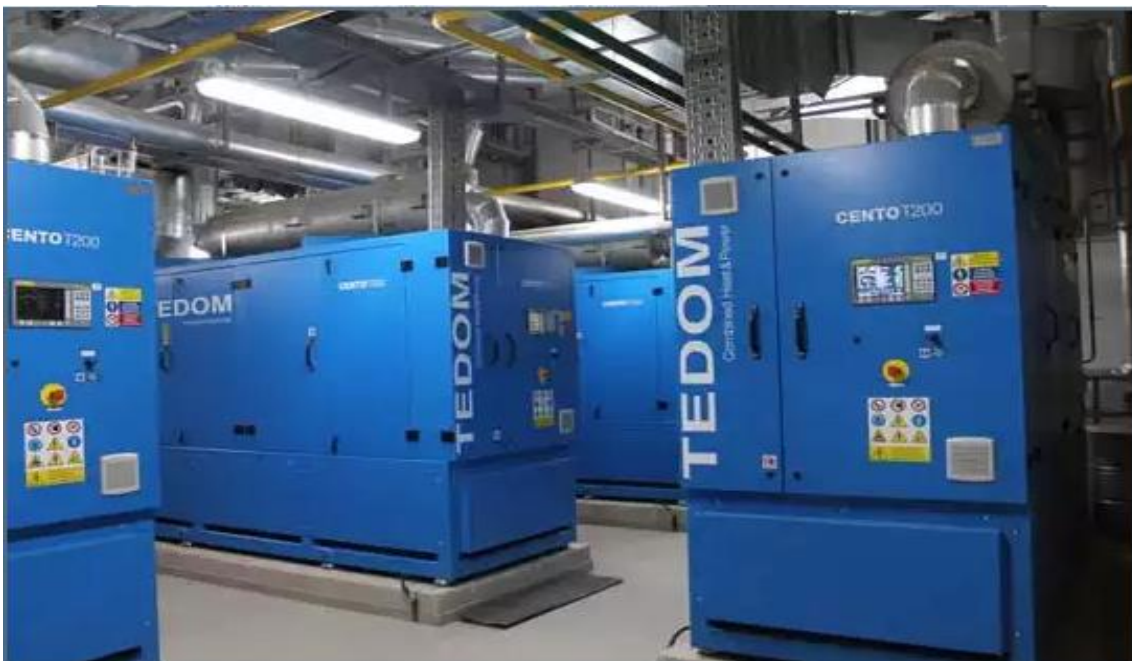
Рис. 3 Модульные когенерационные установки
