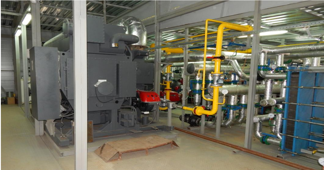
Фото 1. АБХМ в модульном исполнении совместно с ЦТП и пиковым котлом.
