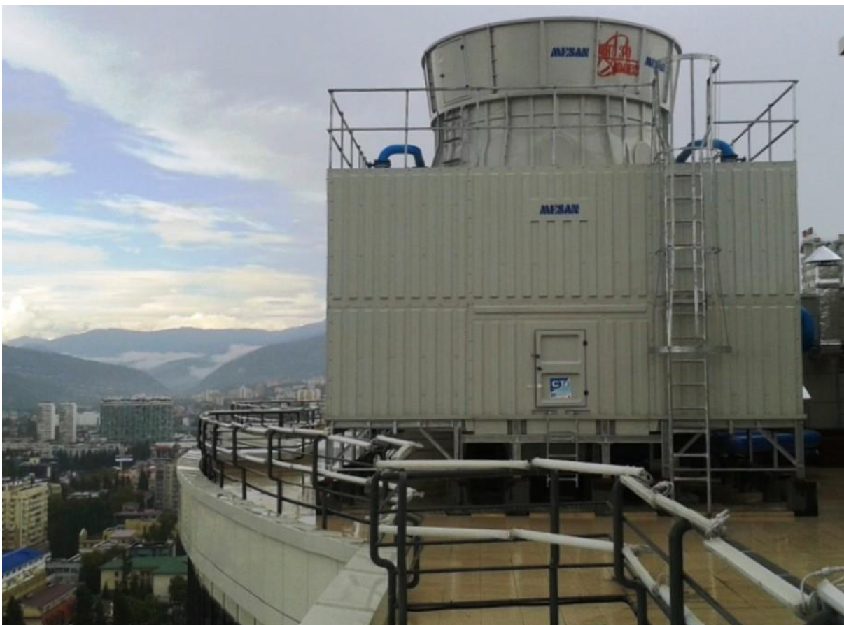
Фото 3. «Мокрая» градирня для АБХМ, установленная на крыше здания для экономии места
